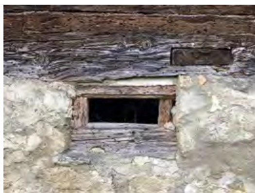
Abb 195 Kellerfenster mit Insektenbefall
